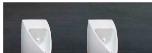
Die Spülstationen sind trinkwasserhygienisch vorbildlich – und über die dezentrale Installation selbst für den Ansturm von 22.000 Zuschauern gerüstet.
