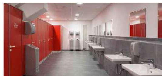
Modern und sicher: Sämtliche Zapfstellen sind hinter der Wand durchgeschliffen, am Ende einer jeden Installationsreihe befindet sich jeweils eine individuell programmierte Spülstation mit Viega Hygiene+ Funktion.
